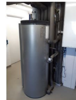
Luft-Wärmepumpe für Brauchwasser
